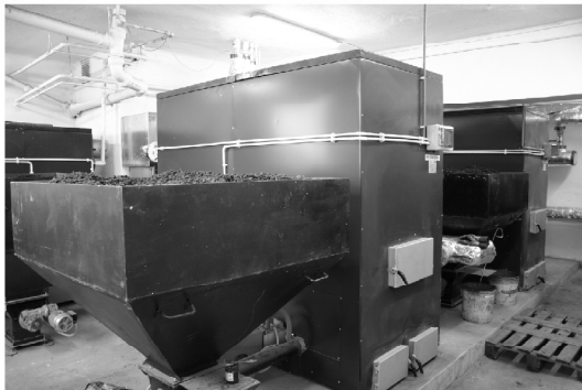
Serce zmodernizowanej kotłowni – nowoczesne zautomatyzowane piecy na węgiel eko-groszek
