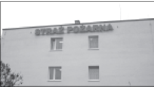
Już widać koniec prac przy ociepleniu głównego budynku strzeleckiej straży. Całość – ok. 1,5 tys m kw. – wykonują sami strażacy.
