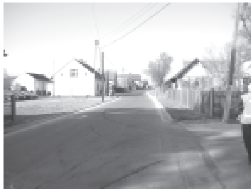
Krasowa. 27 października nastąpił oficjalny odbiór wspólnego zadania Powiatu Strzeleckiego i Gminy Leśnica. Obejmowało ono wymianę krawężnika na długości około 700 m, wykonanie ścieku z kostki betonowej i dwóch studzienek podłączonych do kanalizacji deszczowej.
