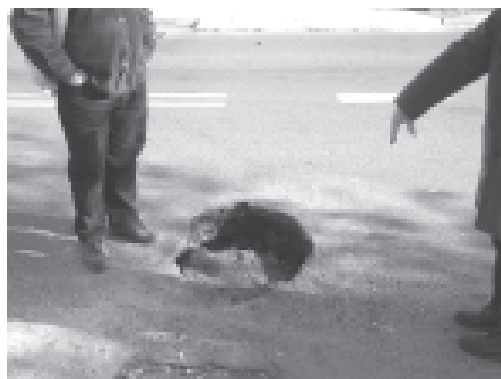
Leśnica, ul. Kozielska. Tak wyglądała dziura po zapadnięciu się studni rewizyjnej na kanalizacji deszczowej. Remont i odwrócenie studni oraz ułożenie nawierzchni na tym kawałku asfaltu trwało w sumie tylko półtora dnia.
