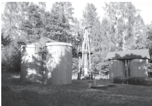
Zmodernizowane urządzenia oczyszczalni
